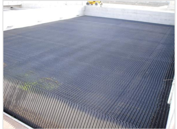
Figura 4: Filtro clarificador lamella
