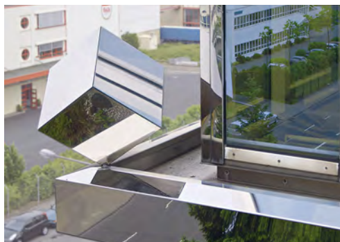
Revestimiento de fachada con acabado recocido brillante antes y después de la limpieza: Las operaciones de mantenimiento estándar devuelven a la superficie altamente reflectante su brillo original. Fotografía: Christian Pohl GmbH, Colonia (Alemania)
