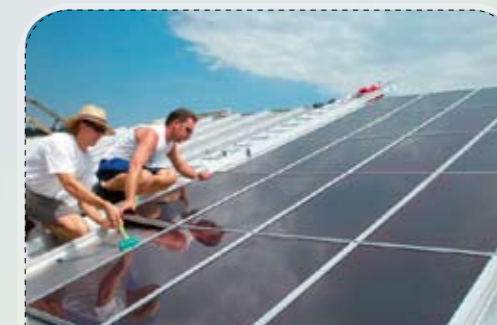
FIGURA 35: Las bandejas del tejado de acero inoxidable sirven de apoyo a los paneles fotovoltaicos (Fotografía: protectum.be)
