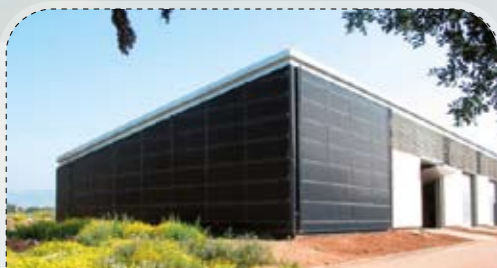
FIGURA 22: Paneles de acero inoxidable utilizados para generar calor en el procesado de una planta de secado de hierbas aromáticas en la isla de Mallorca, España [Fotografía: energie-solaire.com]
