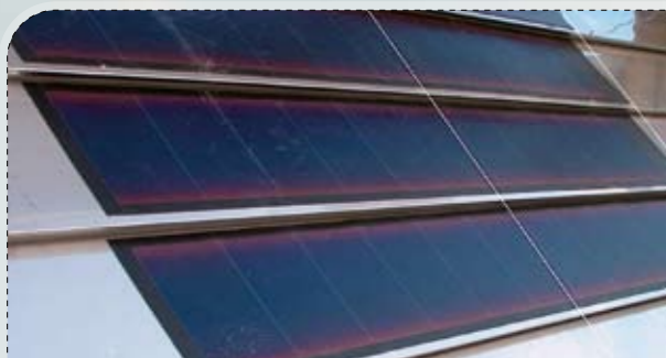
FIGURA 32: Vista detallada de un tejado de acero inoxidable inclinado. Es posible combinar fácilmente secciones fotovoltaicamente activas con otras no activas (Fotografía: thyszen-solartec.com)
