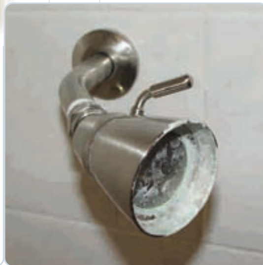
Depósitos de cal en regadera
