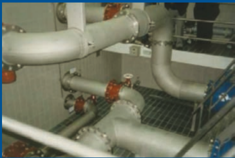
Tubería de acero inoxidable en planta de tratamiento de agua
