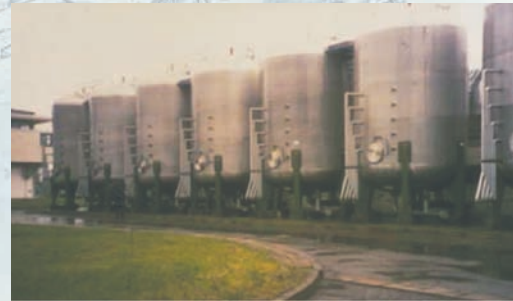
Tanque para proceso de carbón activado
