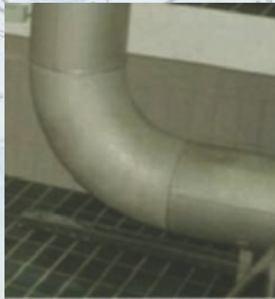
Tubo libre de manchas por calentamiento de soldadura
