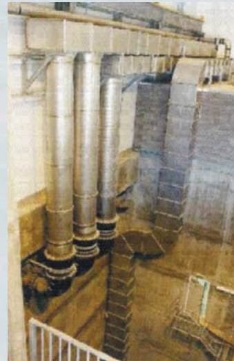
En Inglaterra, los contratistas de obra de plantas de tratamiento de aguas residuales eligieron el acero inoxidable en ductos para el control de olores 1
