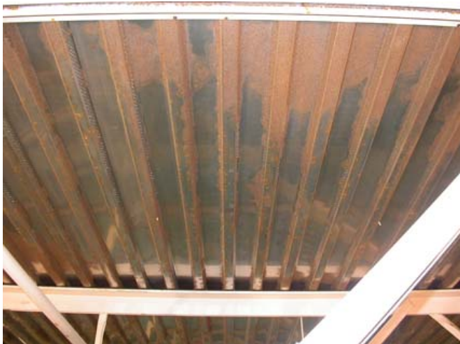
Figura 14: La corrosión de una cubierta de techo de acero inoxidable de tipo 304 encima de una piscina interior. Fotografía cortesía de TRM Consulting .
