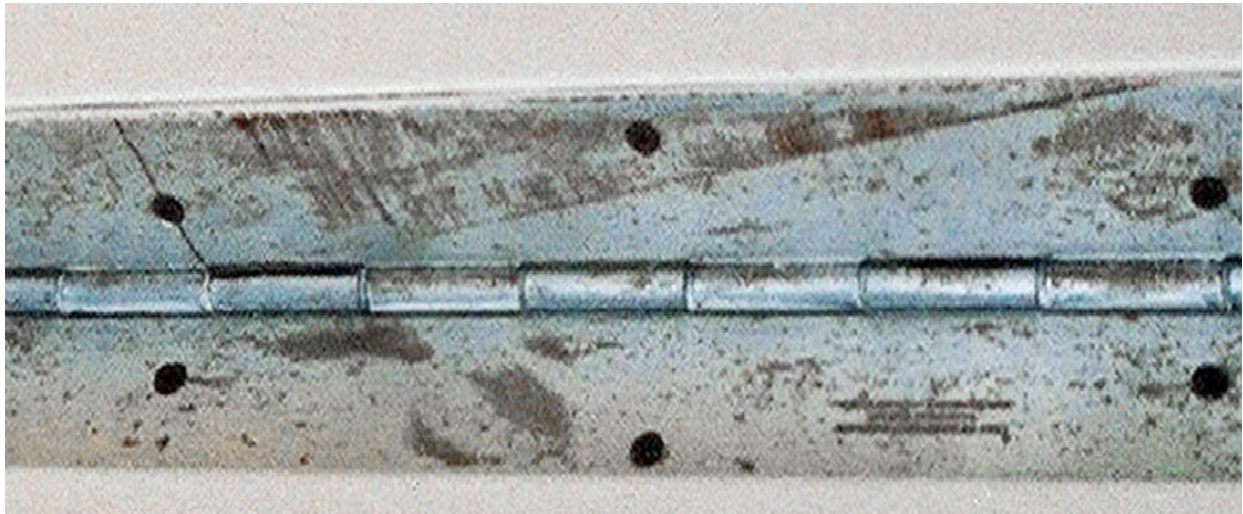
Figura 5: Los cepillos de acero al carbono fueron utilizados por un contratista de limpieza en esta bisagra de la puerta de acero inoxidable que fue instalada a un lado de una piscina interior. Las áreas con contaminación de acero al carbono están oxidadas. (Fotografía cortesía de TRM Consulting ).
