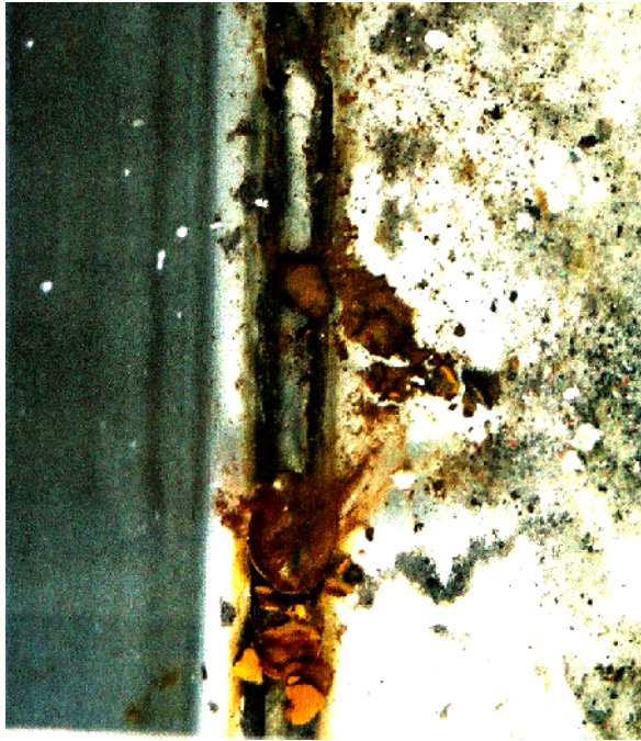
Figura 6: Esta soldadura dentro de una canaleta de la alberca no fue limpiada adecuadamente y la corrosión por picadura está ocurriendo a lo largo de la junta soldada. Fotografía cortesía de TRM Consulting .
