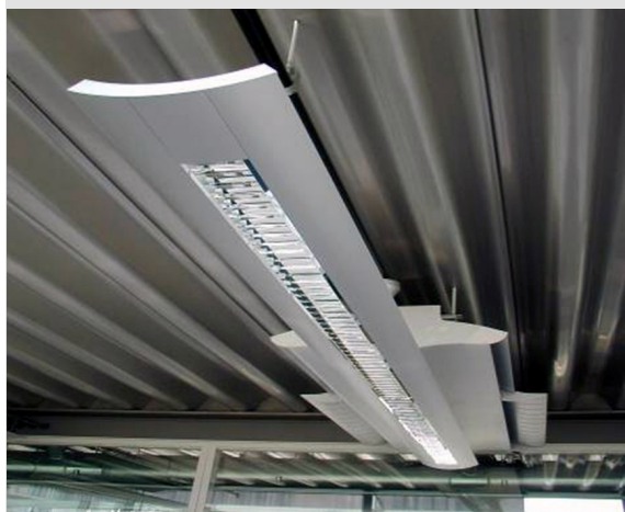
Figura 6: Lámparas y unidades de distribución de aire suspendidas de la cubierta perfilada
