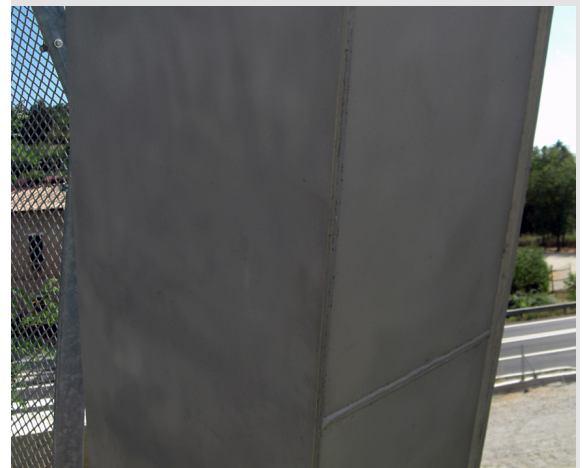
Figura 4: Unión soldada en la torre
