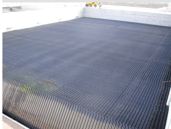
Figura 4: Filtro clarificador lamella
