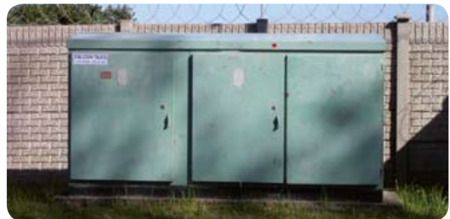
Cuadro eléctrico, tipo 410 pintado, Sudáfrica.
