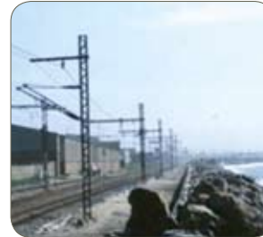
Tipo 1.4003 (primera apli- cación importante en 1982, a lo largo de la costa - 10 m del límite máximo del oleaje, sin corrosión, Sudáfrica)
