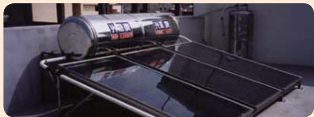
Calentador de agua solar, Taiwan, China
