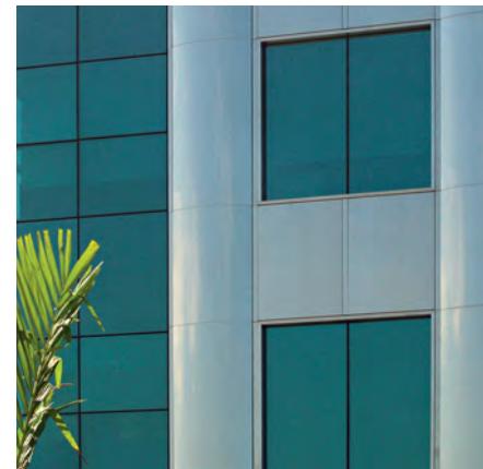
Figura B Acercamiento del exterior del edificio. (Fotografía cortesía de Núcleo Inox)
