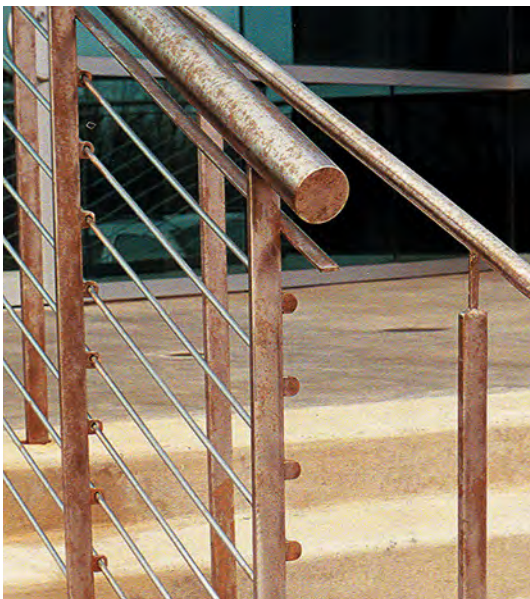
Figura B Un acero inoxidable grado 304 con un acabado rugoso fue la peor elección para el pasamanos expuesto a bruma de un camino donde se utiliza sal para el deshielo. Una limpieza puede remover las manchas, sin embargo, volverán a aparecer año tras año. (Crédito de la fotografía: TMR Stainless)
