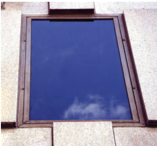
Figura C Este marco de ventana fabricado con acero inoxidable 304 no ha sido limpiado en cinco años. El tipo 304 que está expuesto a sal de deshielo debe limpiarse regularmente para remover los depósitos corrosivos. Aún y cuando se tomen estas precauciones, algo de manchado puede producirse entre limpieza y limpieza. (Crédito de la fotografía: Nickel Institute)
