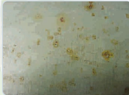
Corrosión localizada por picaduras
