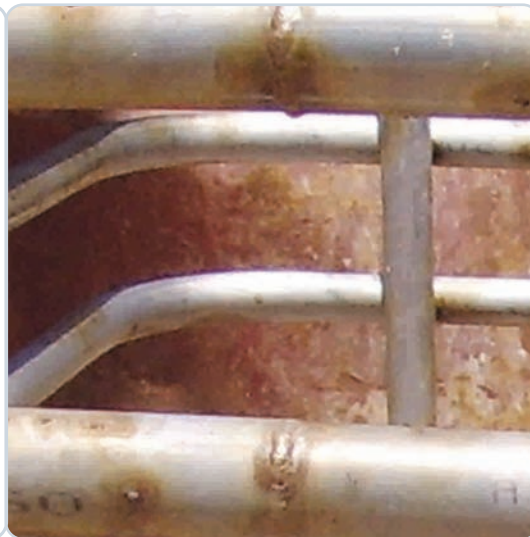
Salpicaduras de soldadura en tubos de acero inoxidable
