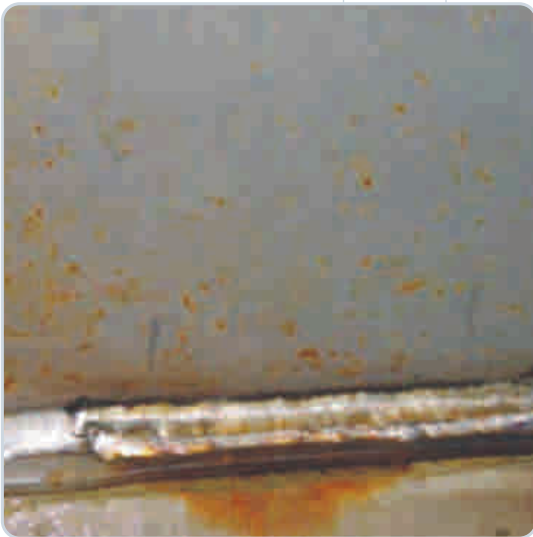
Acero inoxidable contaminado por acero al carbono durante la instalación
