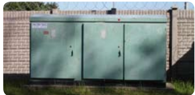
Cuadro eléctrico, tipo 410 pintado, Sudáfrica.
