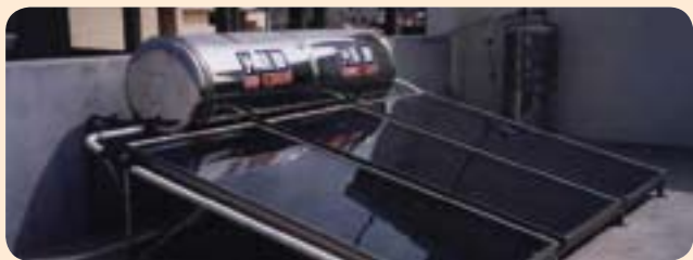
Calentador de agua solar, Taiwan, China
